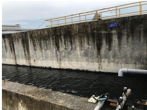
Bể chứa nước thải sau xử lý
