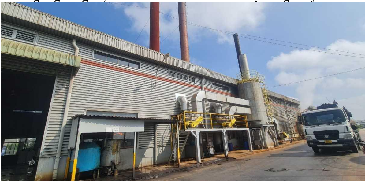
Hệ thống thu gom, xử lý khí thải chung cho 03 lò hơi
