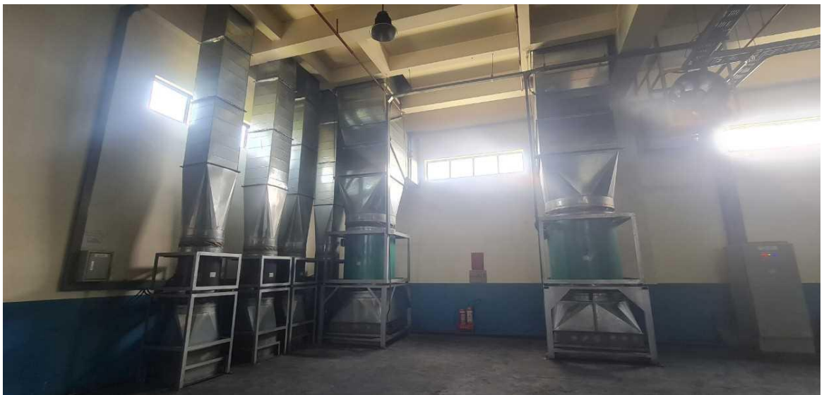
Hệ thống chụp hút, đường ống thu gom nhiệt thừa từ máy luyện keo tại lầu 1 dẫn lên lầu 2, lầu 3
