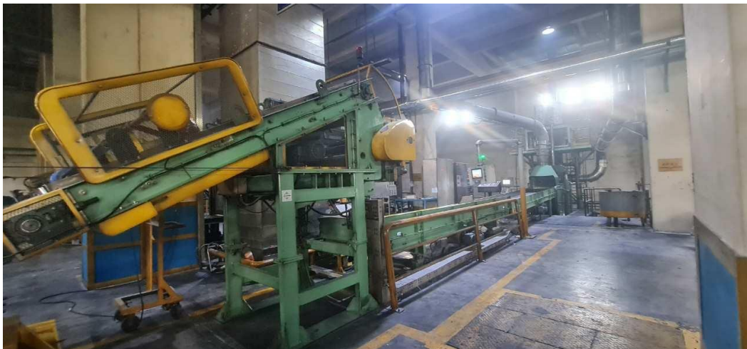
Hệ thống chụp hút, đường ống thu gom bụi, khí thải, mùi từ máy luyện keo tại lầu 1
