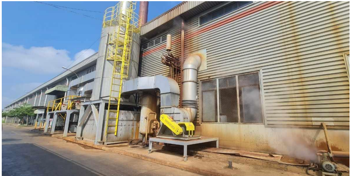
Hệ thống thu gom, xử lý khí thải chung cho 03 lò hơi
