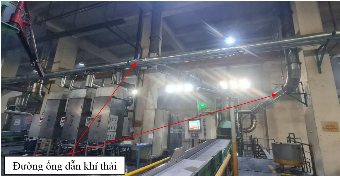
Hệ thống chụp hút, đường ống thu gom bụi, khí thải, mùi từ máy luyện keo tại lầu 1
