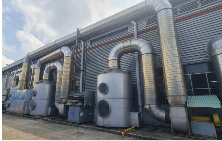
Cụm 1 hệ thống thu gom, xử lý bụi, mùi tại công đoạn ép vỏ (Xưởng vỏ xe ô tô)
