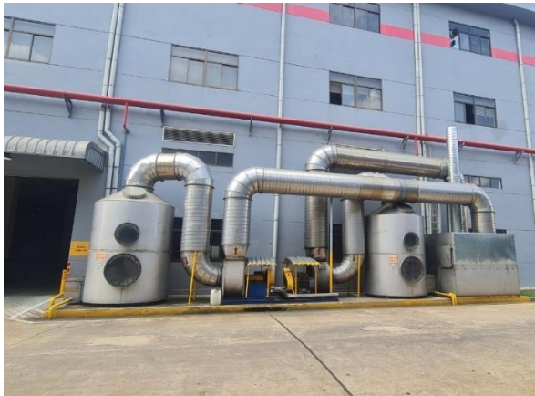
Cụm hệ thống thu gom, xử lý bụi, khí thải, mùi số 3
