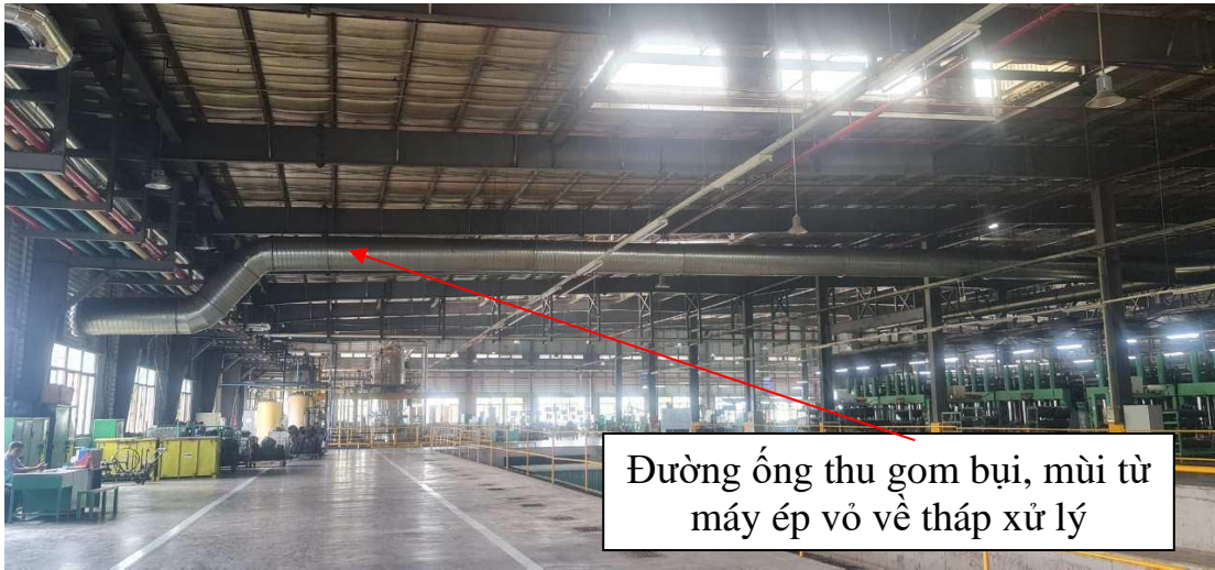
Đường ống thu gom bụi, mùi từ công đoạn ép vỏ đến tháp giải nhiệt (Xưởng vỏ xe máy, xe công nghiệp)
