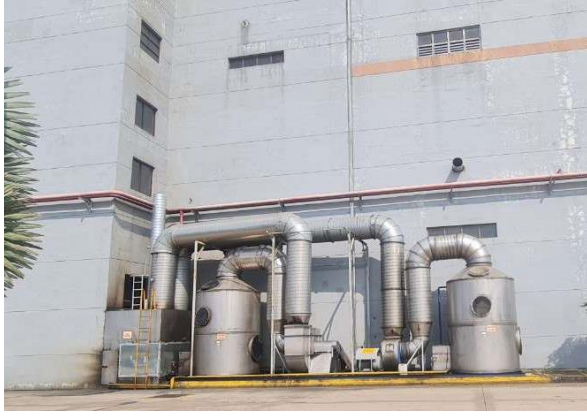
Cụm hệ thống thu gom, xử lý bụi, khí thải, mùi số 1
