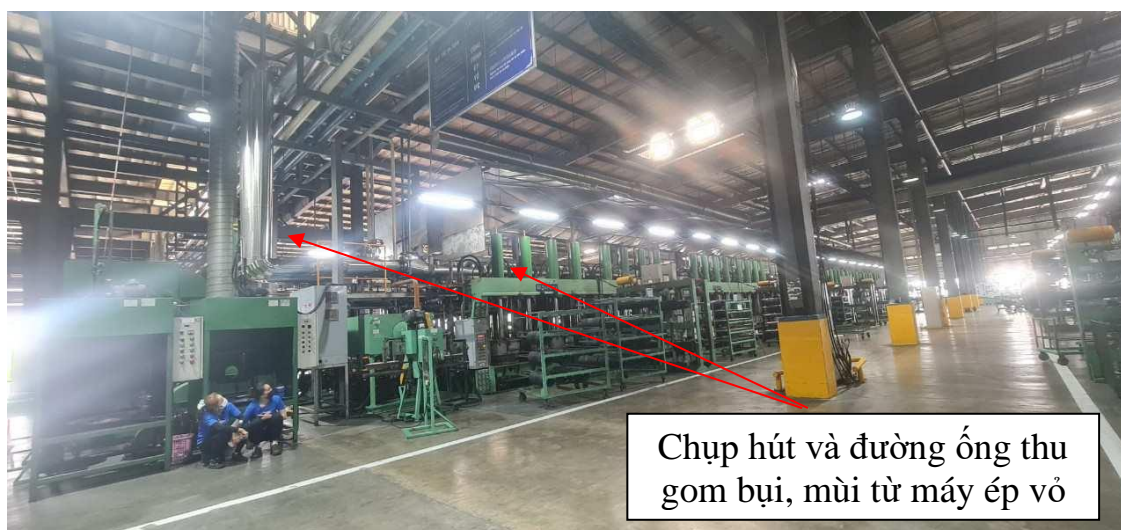
Hệ thống chụp hút, đường ống thu gom bụi, mùi từ công đoạn ép vỏ Xưởng vỏ xe máy, xe công nghiệp
