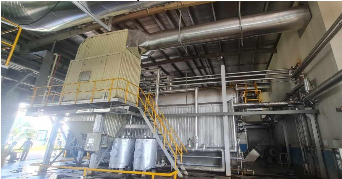
Đường ống thu gom, dẫn khí thải từ các lò hơi về hệ thống xử lý khí thải
