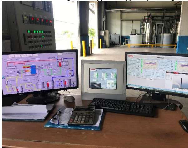
Khu vực điều khiển, giám sát hoạt động của lò hơi
