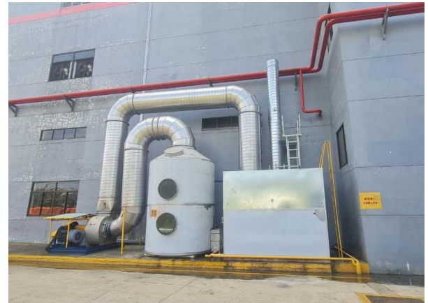
Cụm hệ thống thu gom, xử lý bụi, khí thải, mùi số 4
